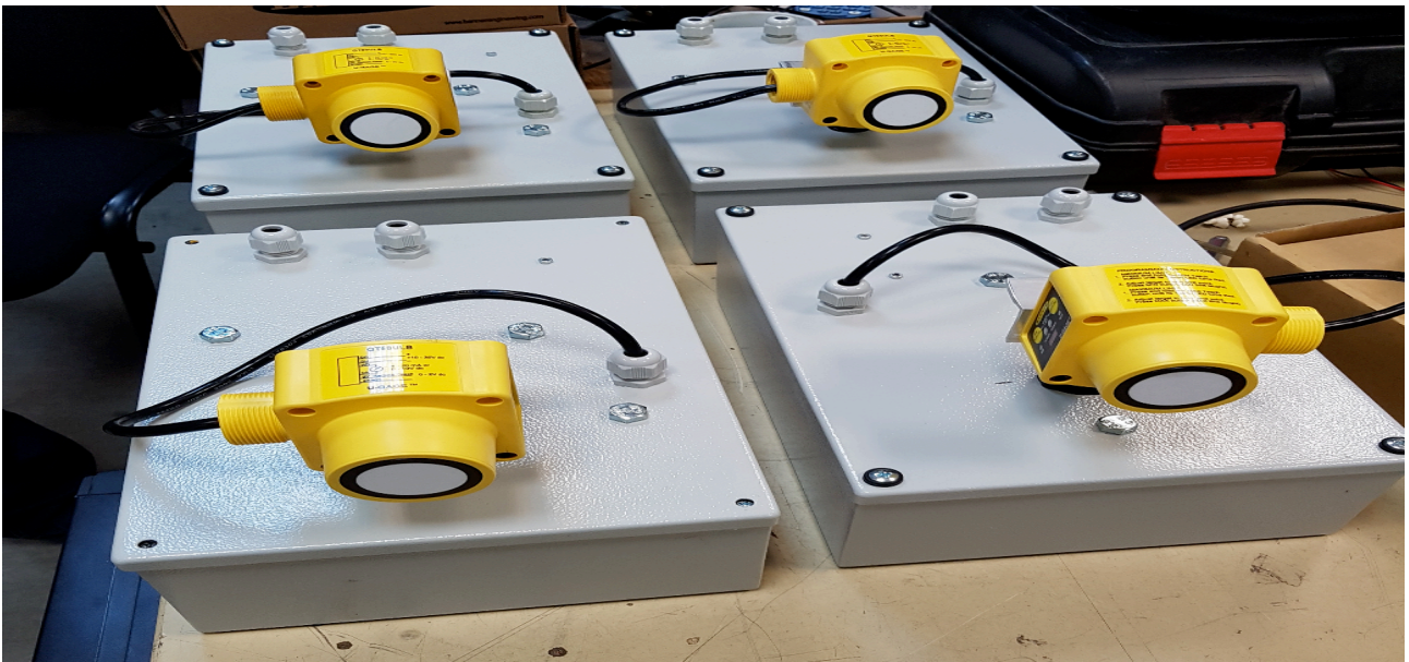
Fig. 25 Ansamblul celor 4 senzori ultrasonici montați pe cutiile servomotoarelor
